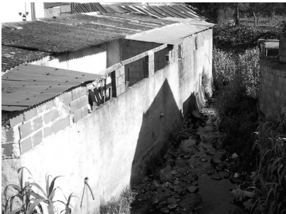
Fotografia 6 — Condições de insalubridade urbana (DGT, 2013)
